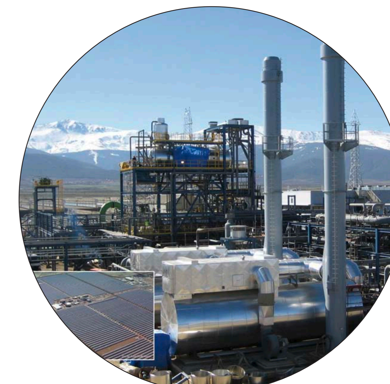
HTT Erhitzer (30 MW) mit Luftvorwärmer zur optimalen Energieausnutzung in der Sierra Nevada
